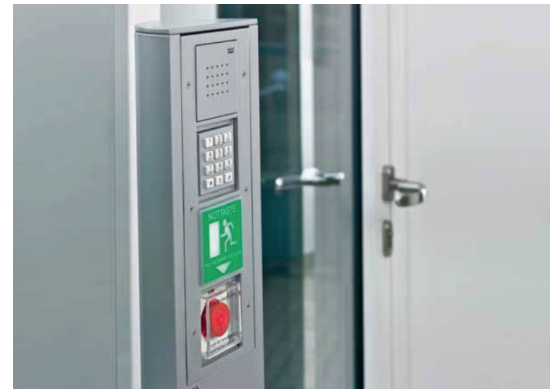
TMS vészkijáratú vezérlőrendszer
